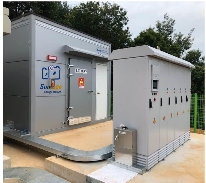
▶ PV 2MW, ESS 7MWh
