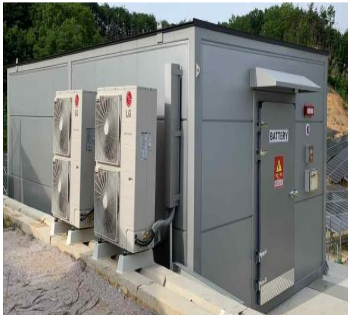
▶ PV 1MW, ESS 3.6MWh
